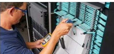
Examiner et résoudre les problèmes de contamination des fibres
