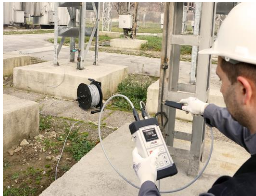
(Figure 3 : Test d'intégrité des réseaux de mise à la terre utilisant la série RMO-EH)
